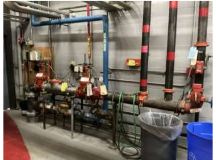
32 - FIRE SPRINKLER RISERS
